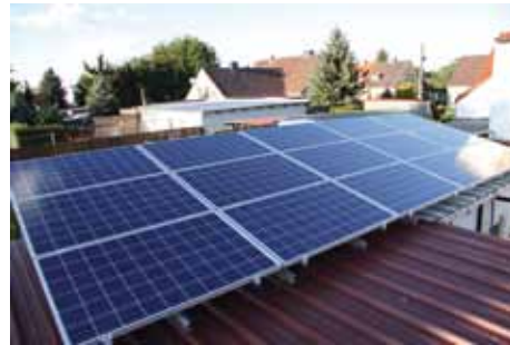
Abb. 2: PV-Anlage S. Winterling
